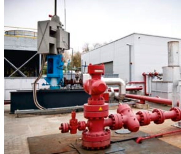
Prototyp: das Geothermie-Kraftwerk in Landau.
